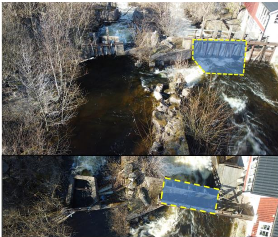
Figur 20. Principiell utformning av en öppning i dammens högra utskov vid Kölefors Övre (sedd uppströms- och ovanifrån). Öppningen bedöms bli cirka 4 m bred i botten och ligga cirka 0,7 m under utskovströsklarna.
