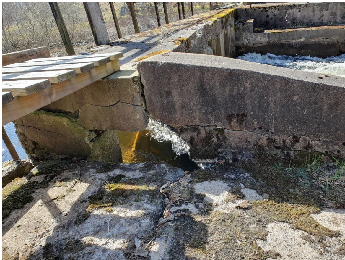
Figur 2. Ett exempel på skada i dammen vid Kölefors Vaddfabrik.
