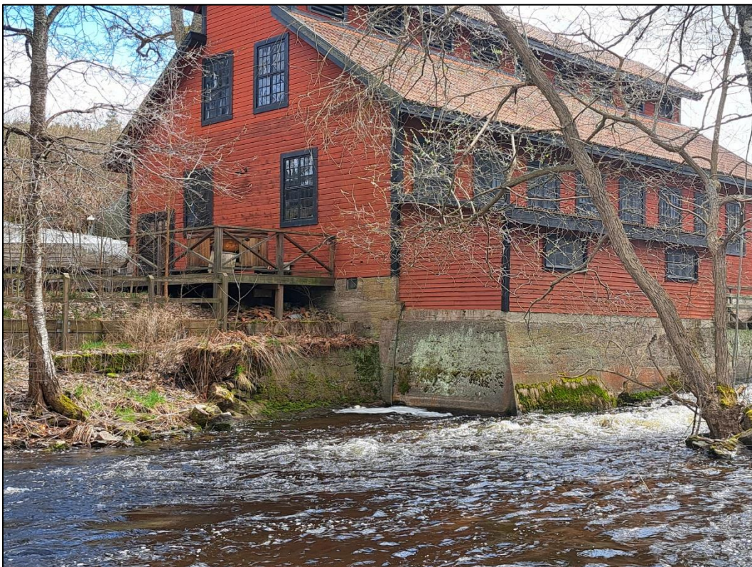
Fig. 76. Smedjan. På bilden syns det igensatta utloppet från turbinen. Foto taget mot s-ö.
